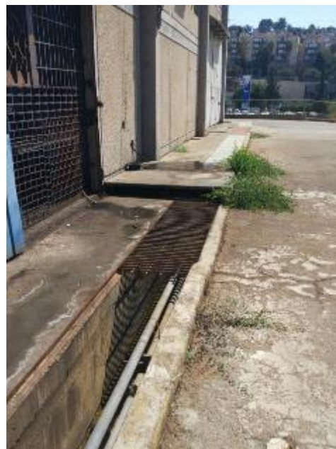
איור 43 - תעלה פתוחה וצינור ניקוז קטן עם כתם שמן נ.צ. 226397/769277
