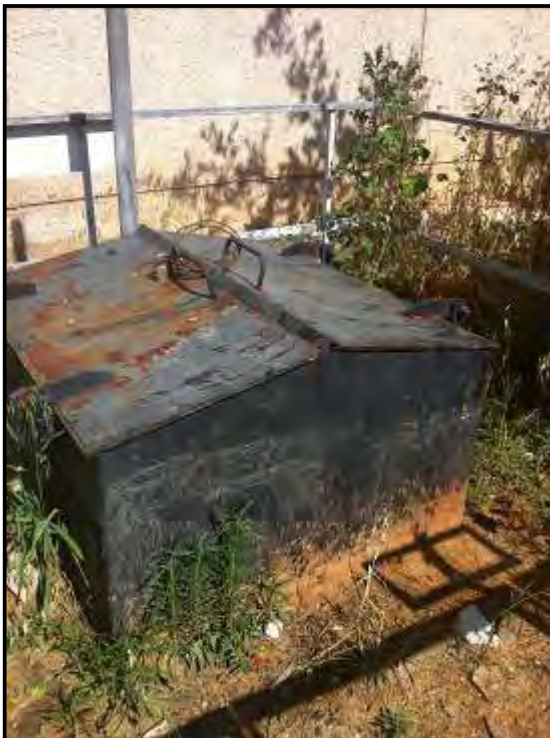
צילום 2: שוחת מכל סולר תת קרקעי בסמוך למתקן אשפוז
