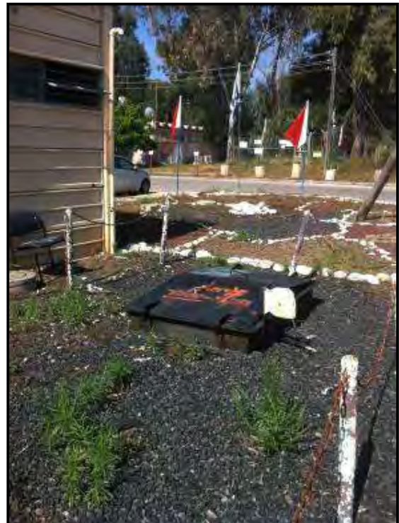
צילום 1 שוחת מכל סולר תת קרקעי בסמוך לחדר חשמל
