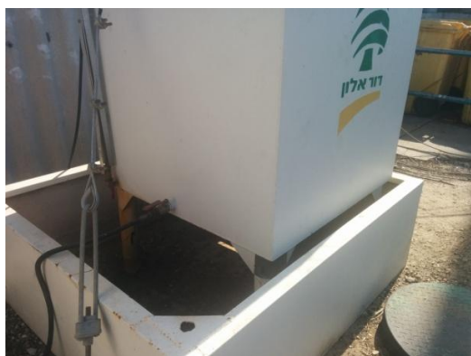
איור 14-4.2.4: מיכל סולר בצמוד לגנראטור. המאצרה מתוחזקת ונקייה.
