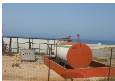
איור 15-4.2.4: מיכל סולר שהיה מוצמד לגנראטור
